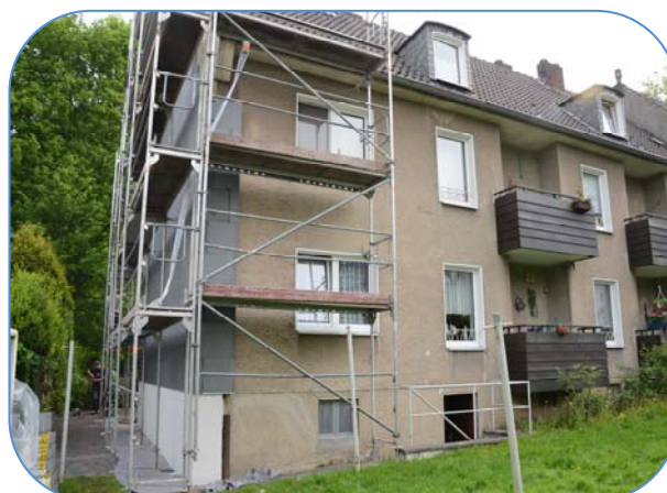
Giebeldämmung „Görlitzer Str.“
