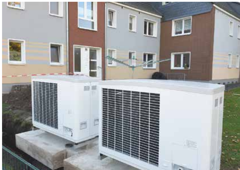
Die neuen Luftwärmepumpen stehen draußen auf der Gemeinschaftsfläche im Mintarder Weg.
