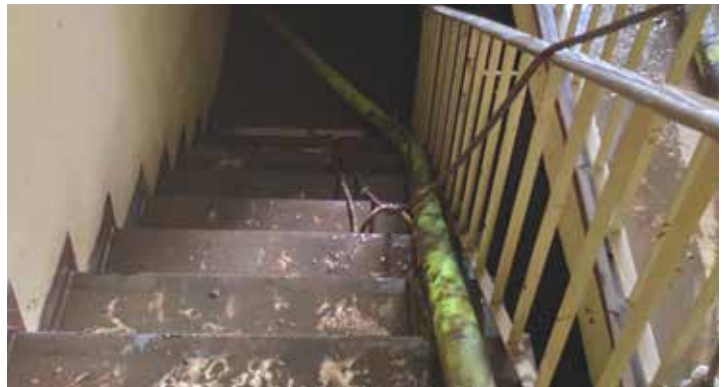
Die Treppen zu den Kellern – alles voller Schlamm, nachdem das Wasser abgeflossen und abgepumpt war.
